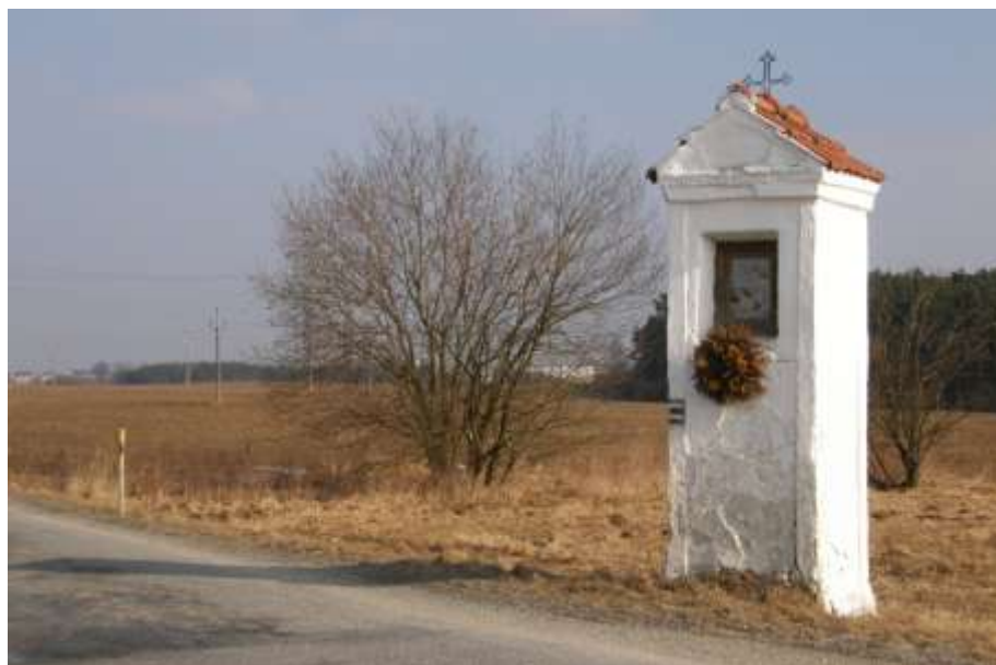
Před opravou, uvolněná „nafouklá“ omítka
