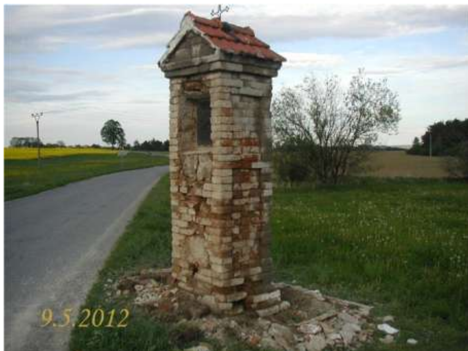
Po odstranění zvětralé omítky – z fotografie je vidět, jak blízko silnice boží muka stojí
