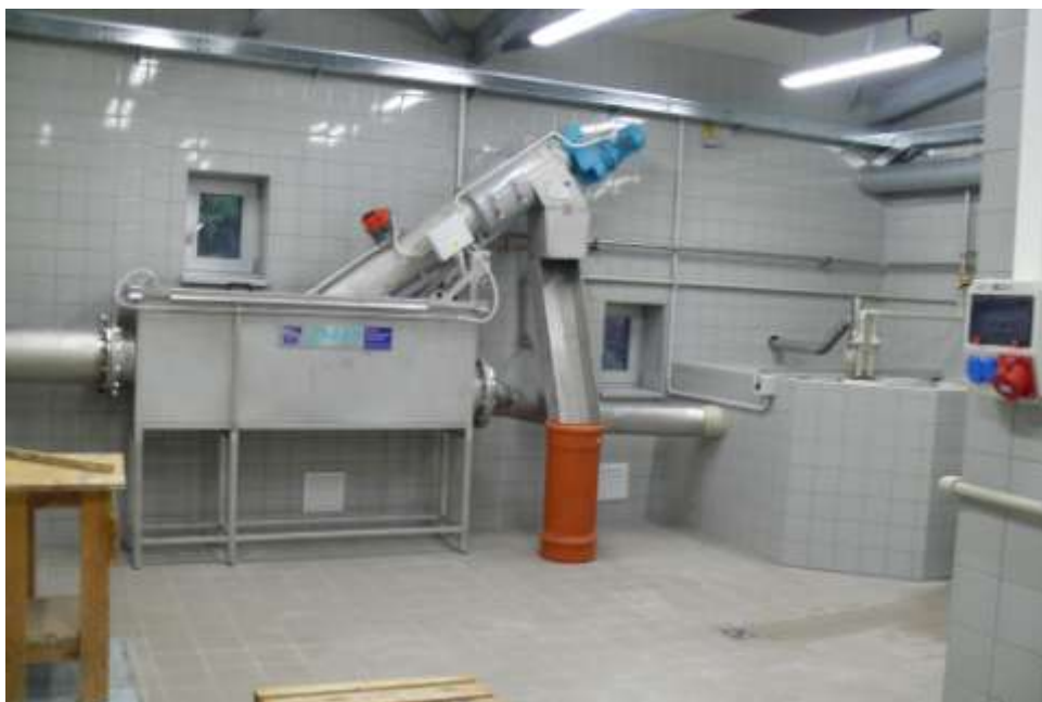
Strojovna separace shrabků
