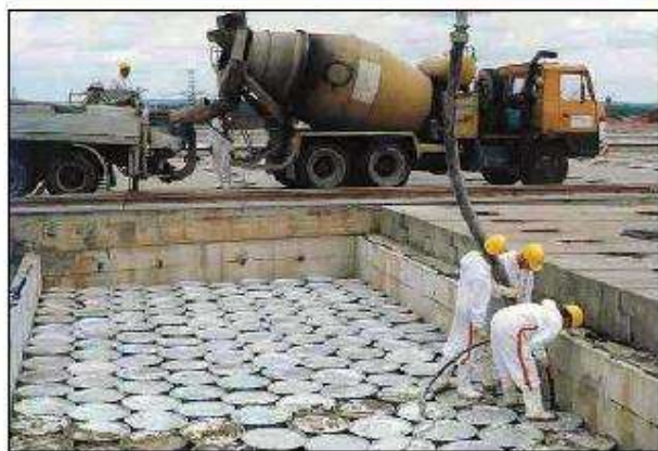
Foto 9: Úložiště RAO v areálu jaderné elektrárny Dukovany
